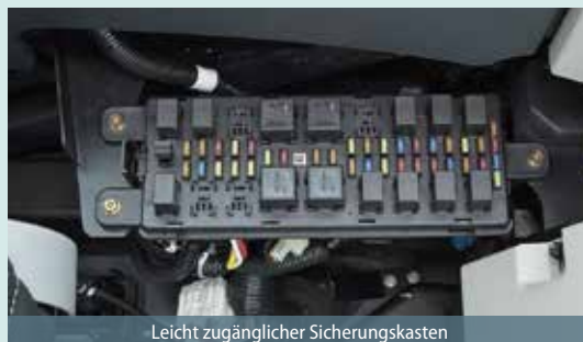
Leicht zugänglicher Sicherungskasten
