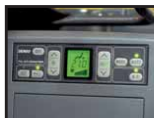
Climatisation à régulation de température
