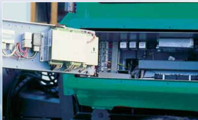
Gut von Aussen erreichbar die Zentralelektrik
