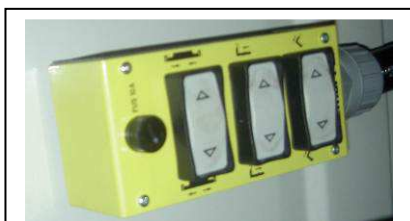
Elektrische Steuerung in der Kabine
