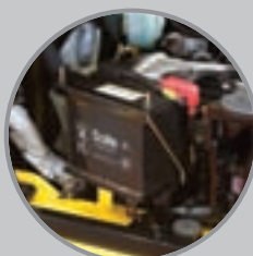
Schwenkbar installierte Batterie
